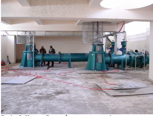
Resim 3. Kuzova Pompa İstasyonu pompa katı
