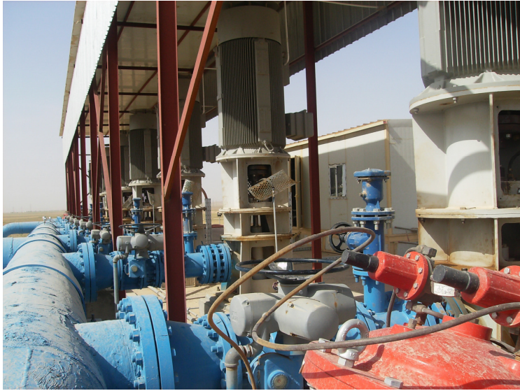
Resim 6. Açık alan bir pompa istasyonu örneği, Irak (Q = 220 l/s – 240 m – 630 kW – 1450 d/d)
