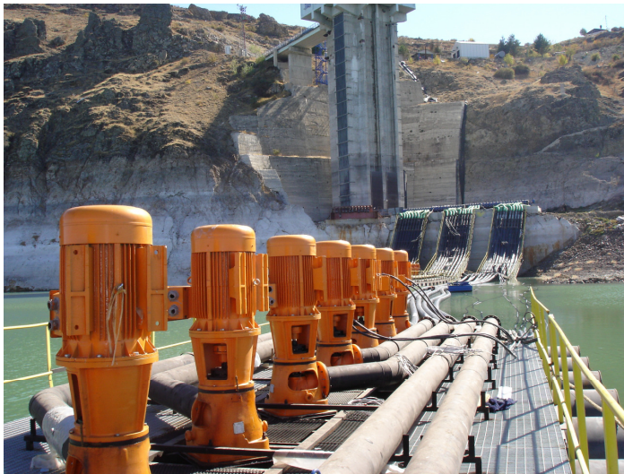
Resim 7. ASKİ Çamlıdere sal üstü pompa istasyonu
