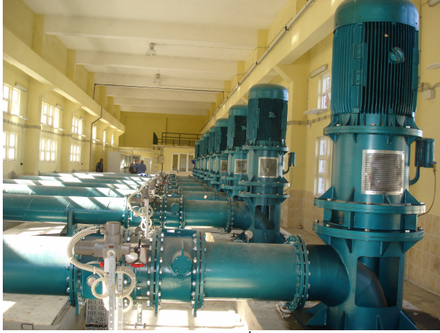
Resim 5. Adana Cevdetiye Pompa İstasyonu (500 l/s – 24 m – 1450 d/d pompalar)
